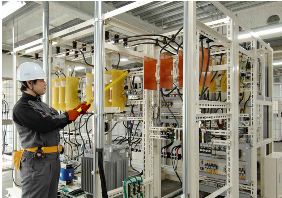
見える化を実現した受変電設備での研修
