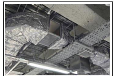
セントラル空調実習場の天井に設置されたダクト。空気の流れを確認できる
