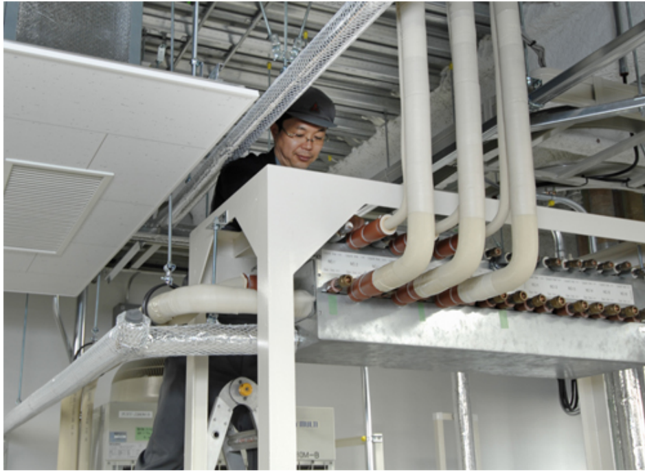
天井裏で空調機の保守技術や運転調整技術を修得
