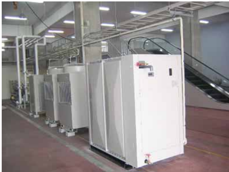
ビル用マルチエアコン室外機
