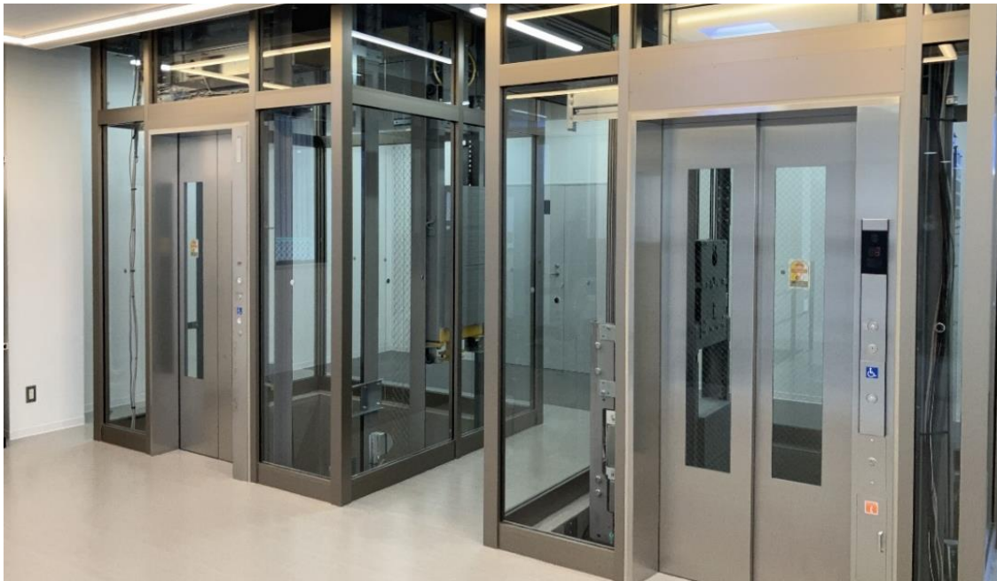
施設内に設置されている研修用エレベーター
