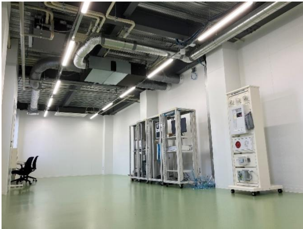
空調冷熱機器やビルシステム等の専用フロア
