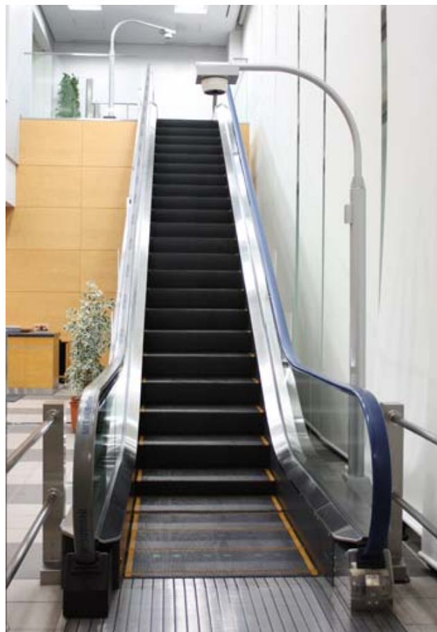
エスカレーター混雑検知システム「パスサーチ」の施工写真(ポールを使用した場合)
