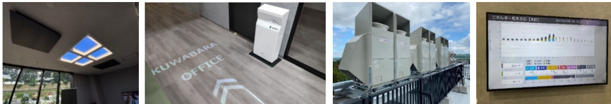
納入した設備・システム
