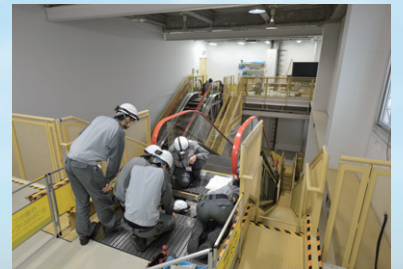
エスカレーター保守実習
